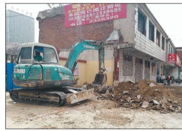
古楼街整改前
