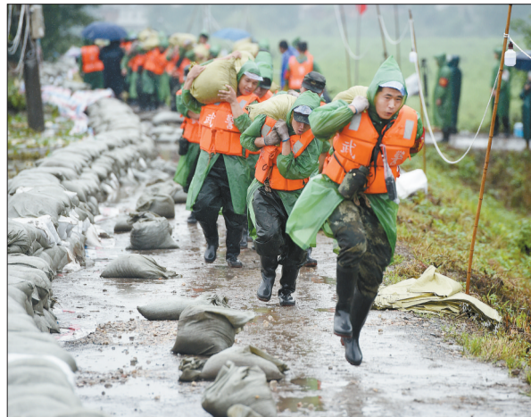
7月16日，在安徽无为长江大堤外护圩三垄圩段，武警安徽总队芜湖支队的官兵搬运沙袋，准备加固子堰。受连日强降雨影响，安徽省芜湖市鸠江区白茆镇的三垄圩部分圩堤沙土流失，先期加固的120处出现松动。接到险情后，武警安徽总队芜湖支队立即出动120名官兵展开抢险，加固子堰，保障无为长江大堤安全。新华社记者 周牧/摄
