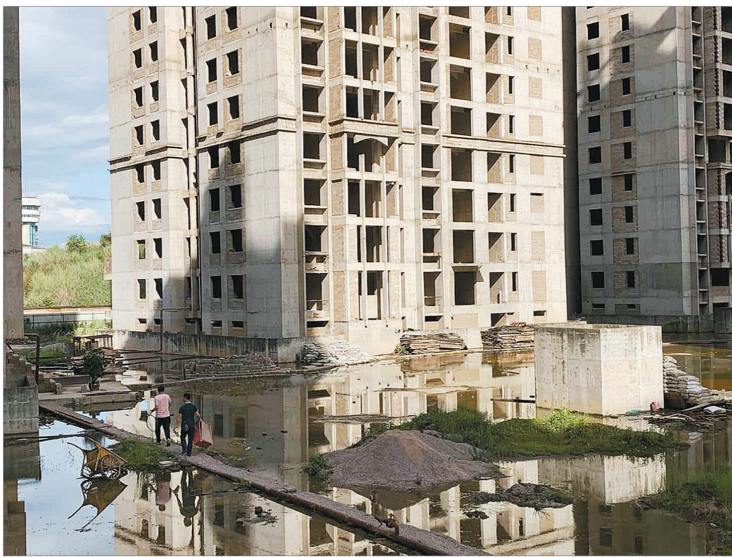
整个楼盘积水严重，建材堆积。
