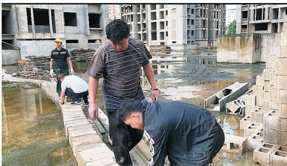
业主们在积水严重的空地上铺起小路。
