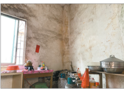
家里的墙壁已布满裂缝。
