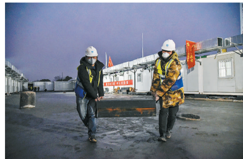
2020年2月1日，武汉市蔡甸区雷神山医院施工现场，中建三局三公司青年突击队队员正在搬运钢管。1月25日，中建三局组织322名员工组成6支青年突击队，从全国各地进行驰援武汉。 中青报 中青网见习记者 鲁冲/摄
