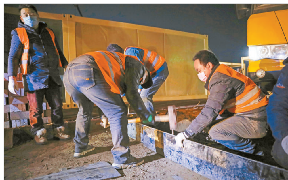
1月16日晚上10点后，河北省石家庄市正定县，疫情防控集中隔离点连夜施工，几名工人正在为隔离板房基础混凝土浇筑做准备。中青报 中青网记者 秦珍子/摄
