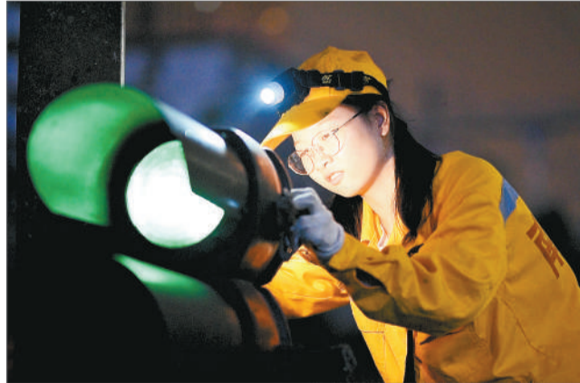
23岁的南宁电务段信号工张梦云利用凌晨天窗点，对管内信号设备进行检修，确保信号设备运行良好，保障春运安全。 钟彼雨/摄
