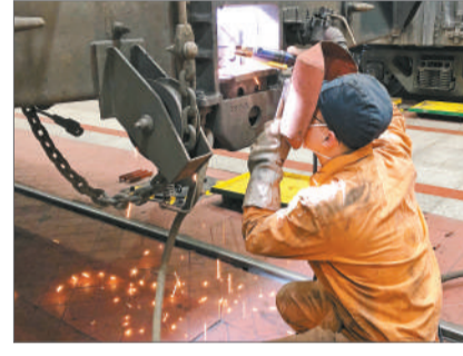
2021年春运即将来临，铁路车辆部门积极备战做好车辆检修工作，全力保障春运铁路运输安全。1月20日，福州东车辆段95后青工袁鹏宇正在检修车辆。 吴鑫珏 向 帅/摄
