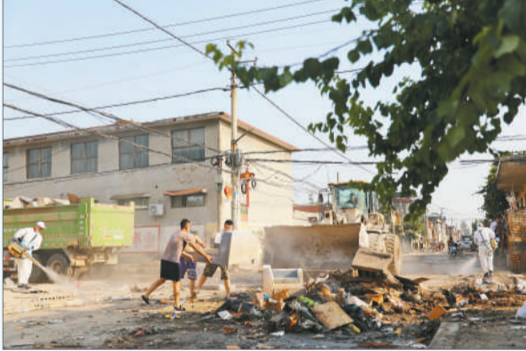
7月30日，河南省新乡市凤泉区鲁堡村，几名村民扔掉被洪水泡过的沙发，志愿者正在喷洒消毒剂。新乡近日多为晴好天气，加上全国多地支援排涝，部分受灾地区水位下降、消退。在新乡农村地区，村民们开始晾晒被洪水泡过的家具、衣物，清理垃圾，查看农田，帮助防疫志愿者消杀，重整家园。 中青报 中青网记者 耿学清/摄
