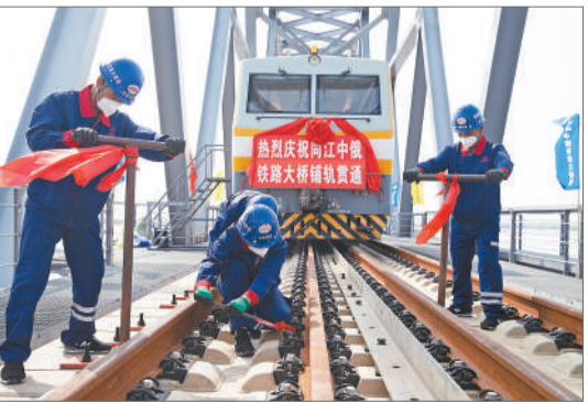
8月17日，工人在同江中俄黑龙江铁路大桥施工现场进行施工。当日，在同江中俄黑龙江铁路大桥施工现场，中俄两国接轨接口最后一组轨道板安装完成，标志着中俄两国首座跨江铁路大桥——同江中俄黑龙江铁路大桥实现铺轨贯通。同江中俄黑龙江铁路大桥位于中国黑龙江省同江市与俄罗斯远东州同江市之间，桥梁全长约7194米。新华社记者 张 涛/摄
