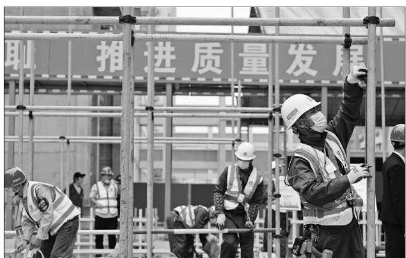
11月3日,由团南宁市委、中建五局华南公司广西分公司联合主办的第三届 青匠 文化节暨职业技能比武在南宁举办。来自项目一线的青工围绕混凝土检测、工程砌筑、财务技能等10个项目展开激烈角逐,各分项比赛第一名将被授予南宁市 青年岗位能手 称号。图为参赛选手比拼脚手架搭设技能。
