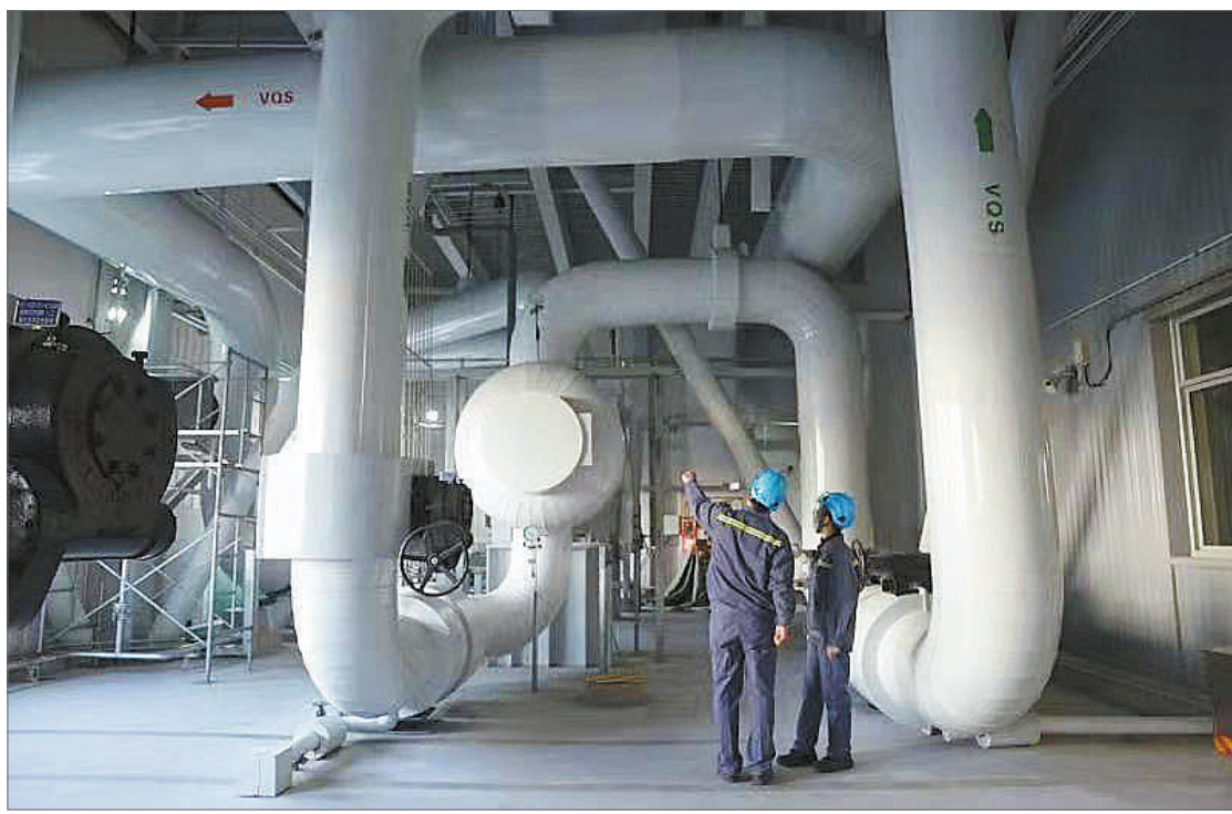
海阳核电站内换热装置所在的吨屋,使用核能加热的热水在这里与通向换热中心的水进行热量交换。
