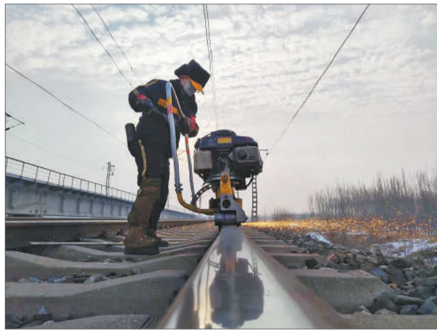
为确保春运期间铁路运输安全,中国铁路济南局集团公司淄博工务段周村线路工区突出抓好线路防断工作,在防断重点处所严格执行各项作业标准,对钢轨焊缝接头等部位进行钢轨打磨,消除线路病害。图为1月24日,工区刘国麟在对钢轨焊缝进行打磨。郭修山/摄
