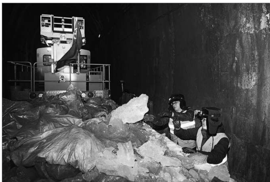
2022年春运以来,海拉尔工务段组织牙克石路桥车间青年突击队,全力保障春运期间隧道运输安全。青年突击队已出动百余人次,累计除冰800余吨。图为牙克石路桥车间职工正在兴安岭隧道内进行除冰作业。 卢勇/摄
