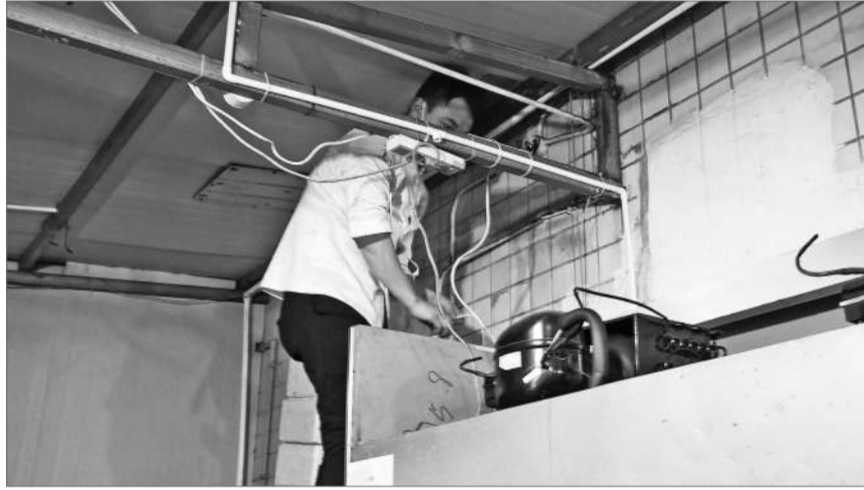
在督导组检查组的要求下,火锅店的员工爬上储物架,将燃气报警器通上了电。
