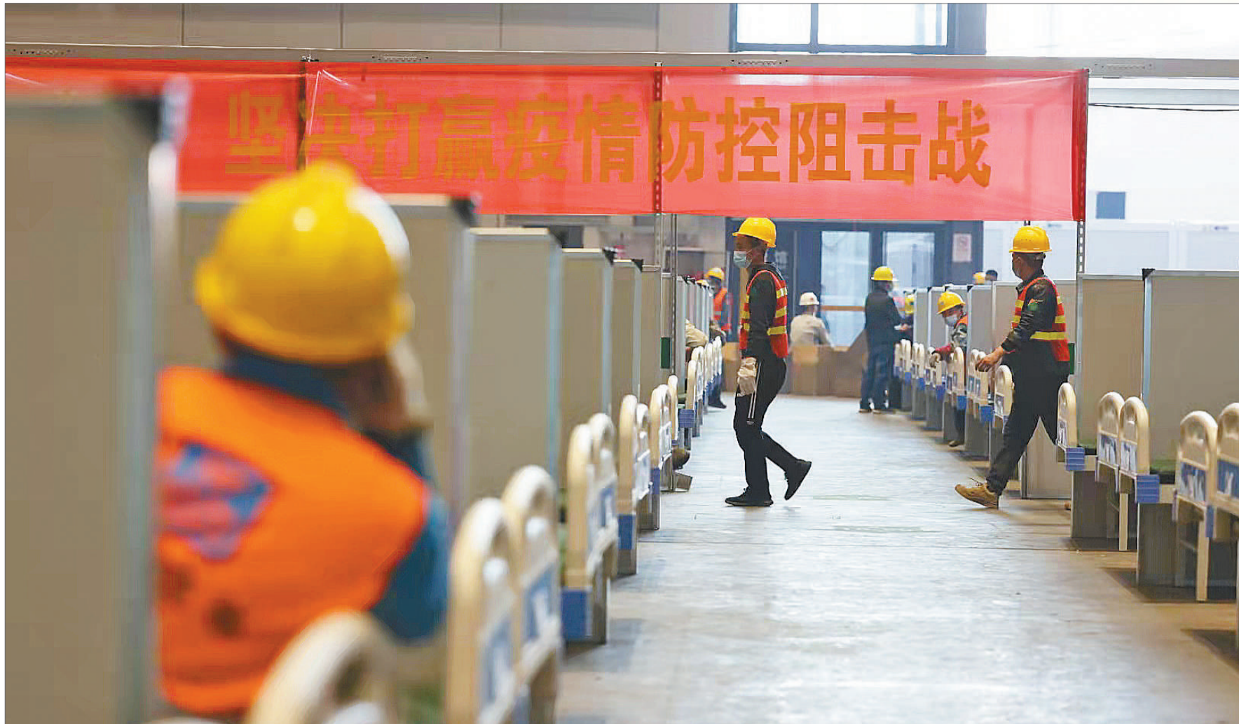
4月8日,上海市青浦区国家会展中心,施工现场拉起横幅 坚决打赢疫情防控阻击战。此处上海最大的方舱医院从4月5日开始动工,工人们在其中夜以继日地劳作着。 中青报 中青网记者 李强/摄
