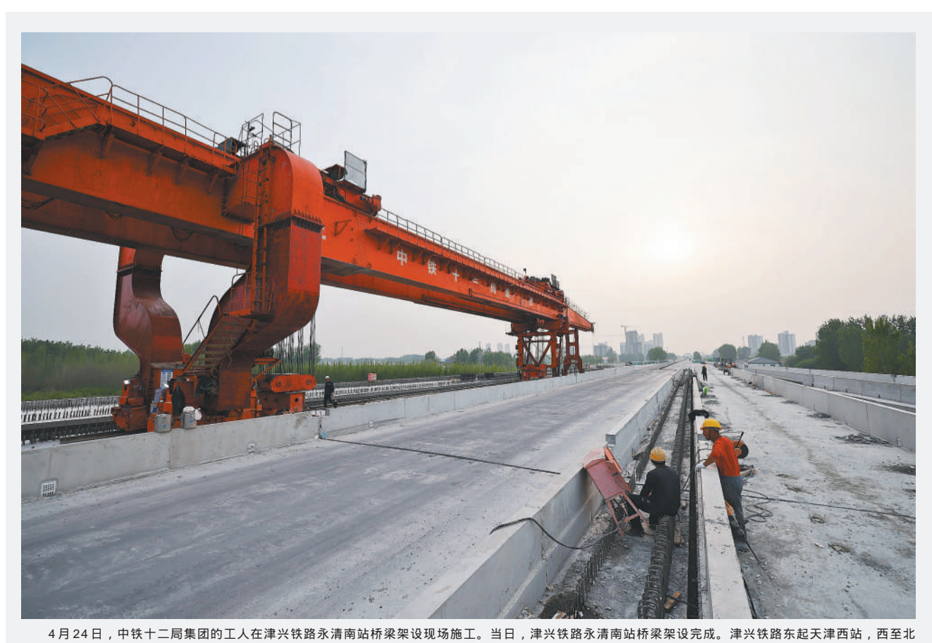
4月24日,中铁十二局集团的工人在津兴铁路永清南站桥梁架梁施工现场。当日,津兴铁路永清南站桥梁架梁完成。津兴铁路东起天津西站,西至北京大兴国际机场,全线建成通车后,将进一步优化京津冀地区铁路网布局,促进京津冀交通协同发展。 新华社记者 邢广利/摄
