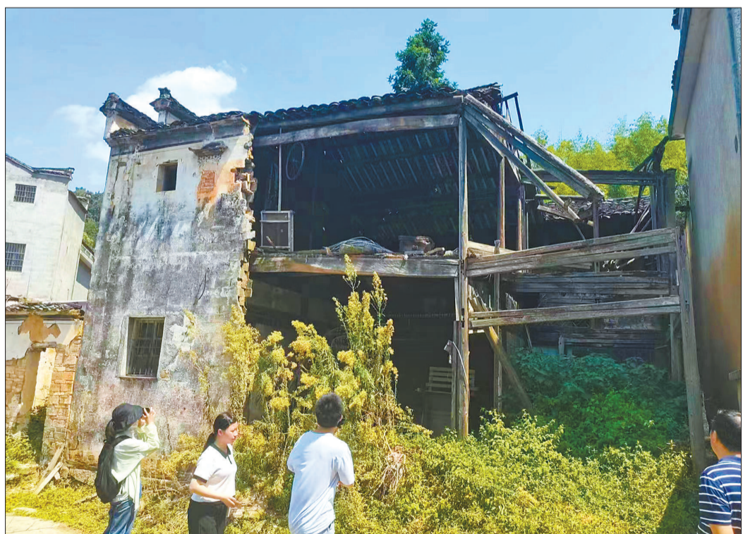
安徽建筑大学公管学院大学生在基层排查和测量自建房屋。
