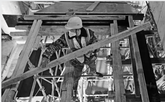
1月2日,北京地铁10号线三元桥车站改造工程施工现场,36岁的木工范二松在脚手架上铺木板。中青报 中青网记者 陈剑/摄
