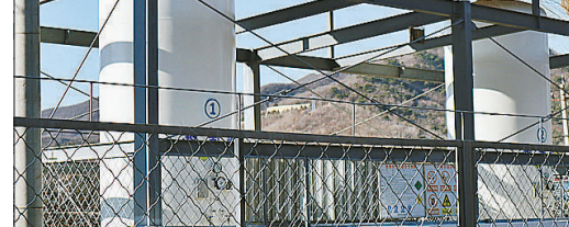
北京老年医院液氧站里，两个容积为5立方米的液氧罐。
