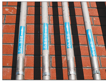
北京老年医院的部分供氧管道。
