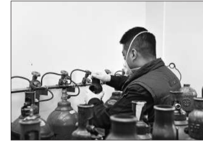
北京大学第三医院总务处医用气体组员工在进行氧气汇流排的切换操作。受访者供图
