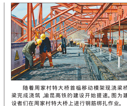
随着周家村特大桥首幅移动模架现浇梁完成浇筑，渝昆高铁的建设开始提速。图为建设者们周家村特大桥上进行钢筋绑扎作业。
