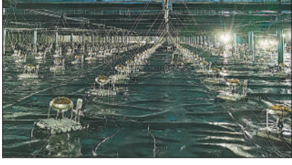
LHAASO装置WCDA三号水池内安装完成的光电信增管。 中科院高能所供图
