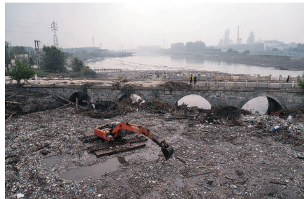
8月10日上午,北京市房山区琉璃河镇琉璃河桥边,相关人员正在清理琉璃河河面上被洪水冲来的垃圾。连日来,当地逐步开展清淤、消杀、排涝等灾后恢复工作。 中青报·中青网记者 李峥危/摄
