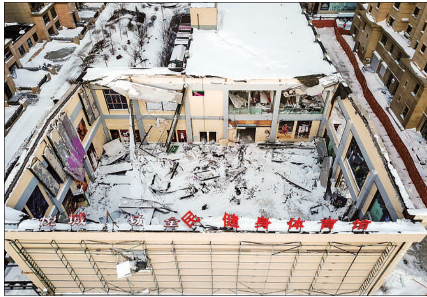
这是11月7日拍摄的发生屋顶坍塌事故的黑龙省桦南县悦城体育俱乐部(无人照片)。
