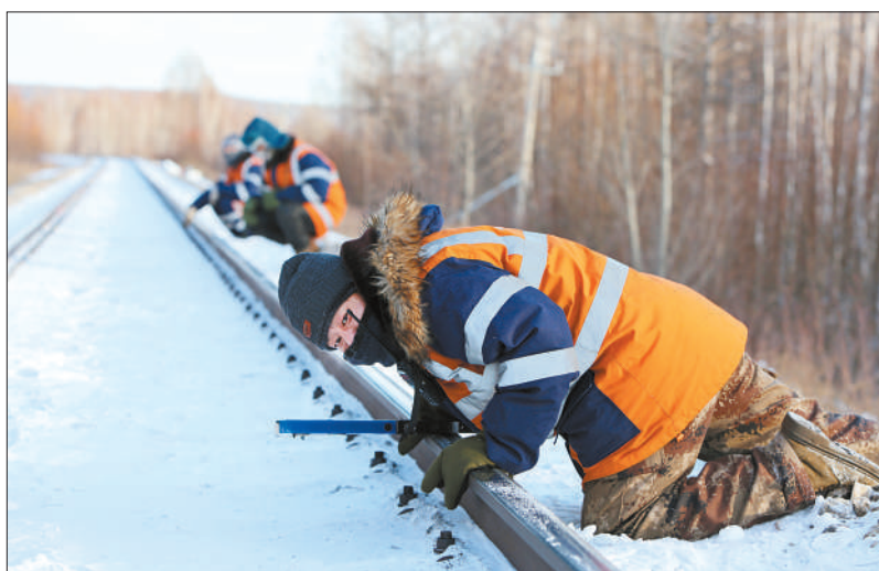
12月20日，在中国铁路哈尔滨局加格达奇工务段，漠河车间带班工长耿在钢轨上目测现场坑洼情况，确定作业位置。在中国铁路哈尔滨局加格达奇工务段，受低温影响，铁路路基土体易在冻结过程中发生冻胀，造成钢轨高低起伏不平，增加行车安全风险。漠河车间职工采取垫板、捣固等方式消除冻害，使线路平顺稳固，保障旅客乘车安全。新华社记者 石枫/摄
