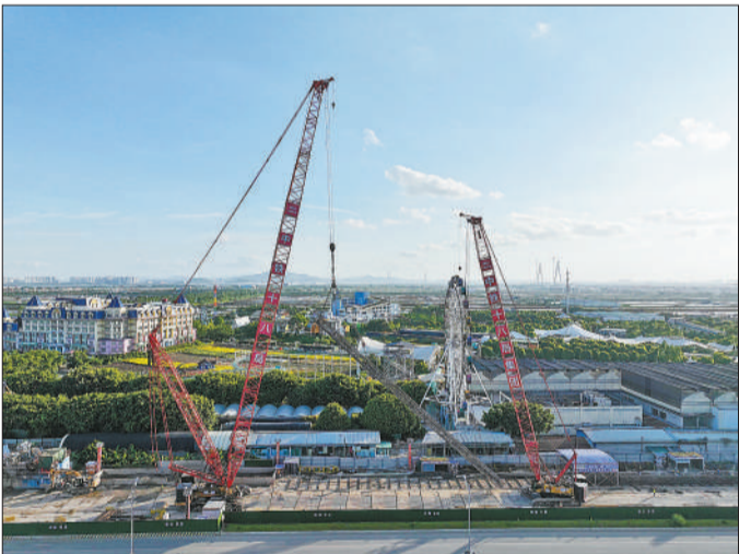
临近龙年春节，中铁十八局承建的新建广州站至广州南站联络线工程GNSG1标段现场热情不减，抬钢筋、对长度、轧角度，建设者们默契配合，施工现场一片火热。
