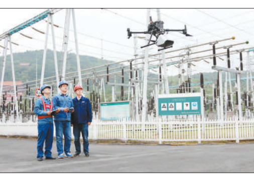
近日，国网安徽电科院“电力声纹”柔性团队青年技术人员在马鞍山220千伏刘村变电站开展“无人机+声纹检测”服务工作，采取声学成像技术诊断电力设备运行状态，确保可靠供电。 杨为/摄
