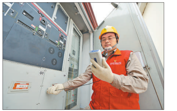
全国劳模模范黄旭对配电设备进行带电检测
